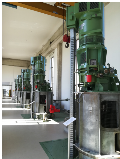
Le cinque pompe della II sala macchine
