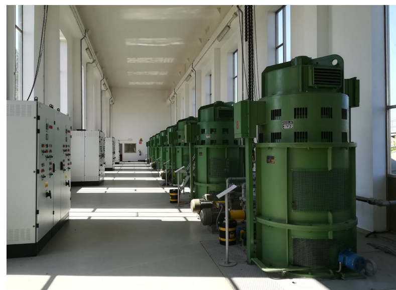
Le otto pompe della prima sala macchine
