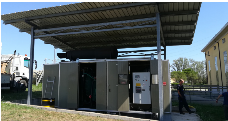
Il gruppo elettrogeno da 1050 KVA in grado di far funzionare circa la metà dell'impianto
