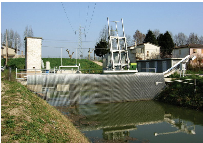
L'impianto Fontana con in primo piano lo sgrigliatore automatico a Fratta (Consorzio Adige Canalbianco 2005)
