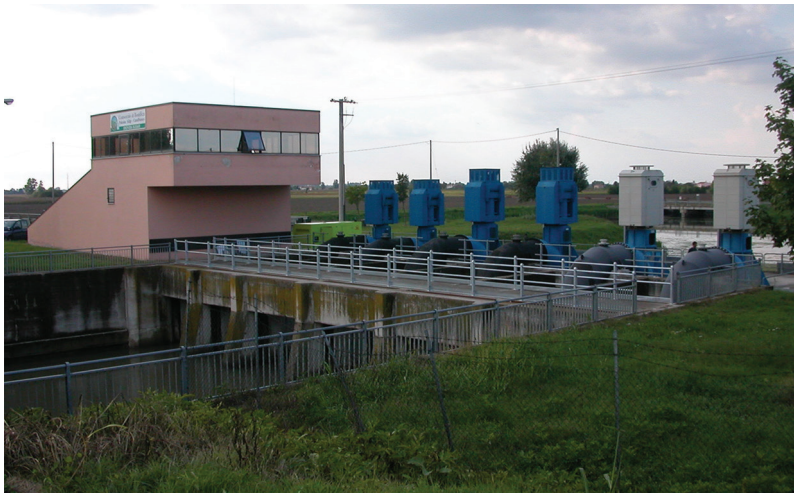
Impianto idrovoro Bussari (Consorzio Adige Canalbianco 2007)
