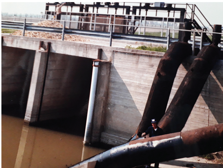
Particolare tubazioni provvisorie per lo scarico del Valdentro presso la chiavica Bussari (Consorzio Medio Polesine anni '70)
