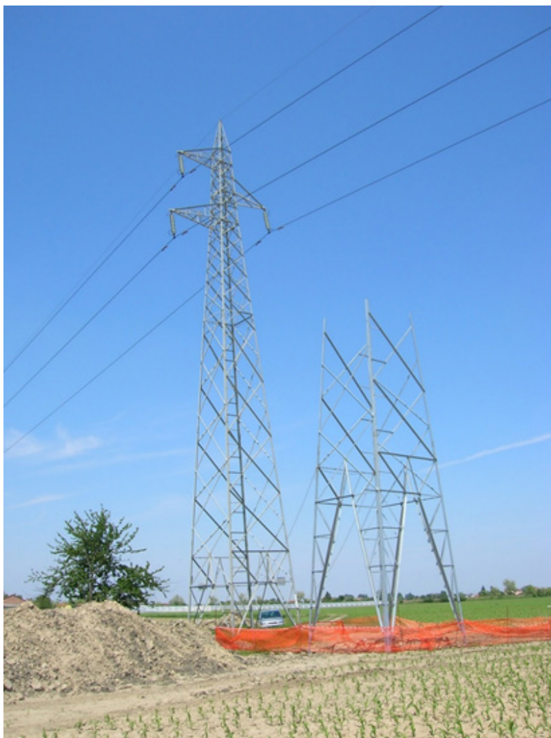
Il traliccio dell'Alta Tensione ricostruito a Fratta nel 2005
