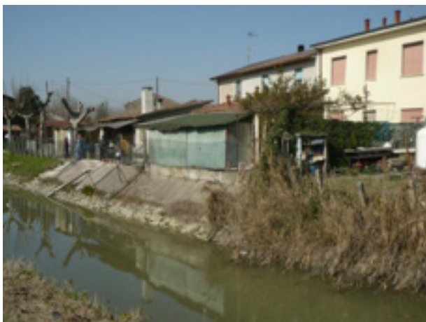
Situazione di degrado lungo i canali
