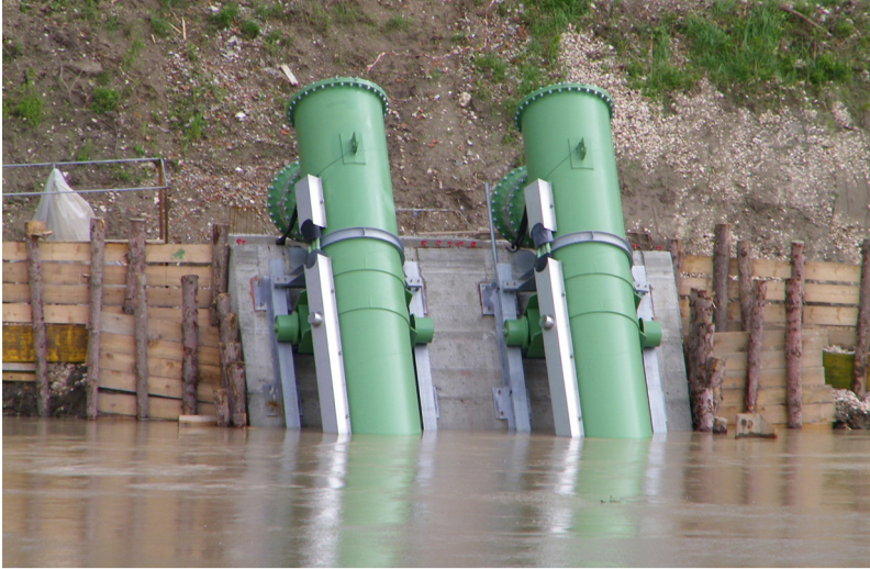
Tubi contenitori delle elettropompe
