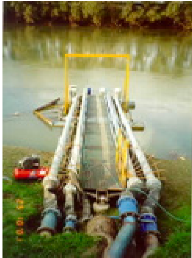
Batteria di pompe su galleggiante
