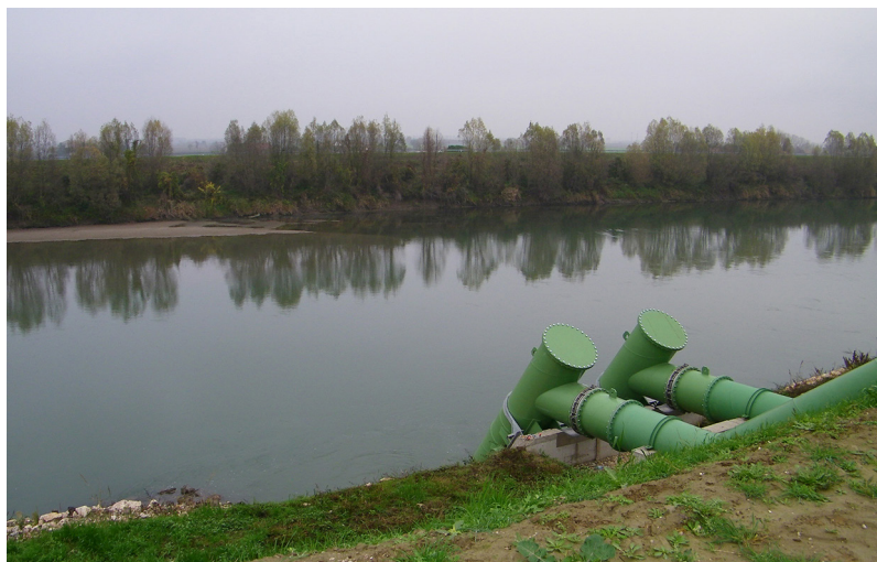
Contenitori pompe di Cantonazzo
