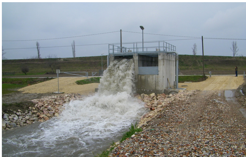
Impianto in funzione con una pompa
