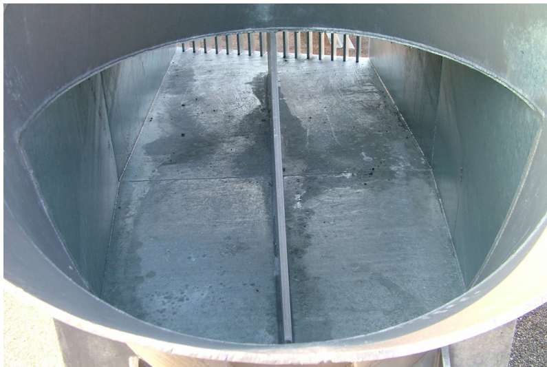
Particolare struttura di aspirazione pompe
