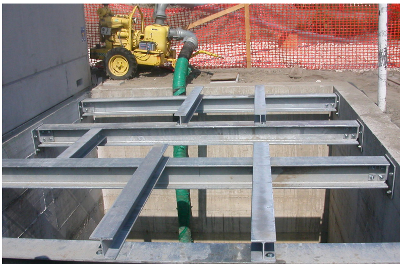
Travi di supporto pompe impianto Cavana
