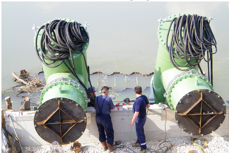
Posizionamento elettropompe e cavidotti
