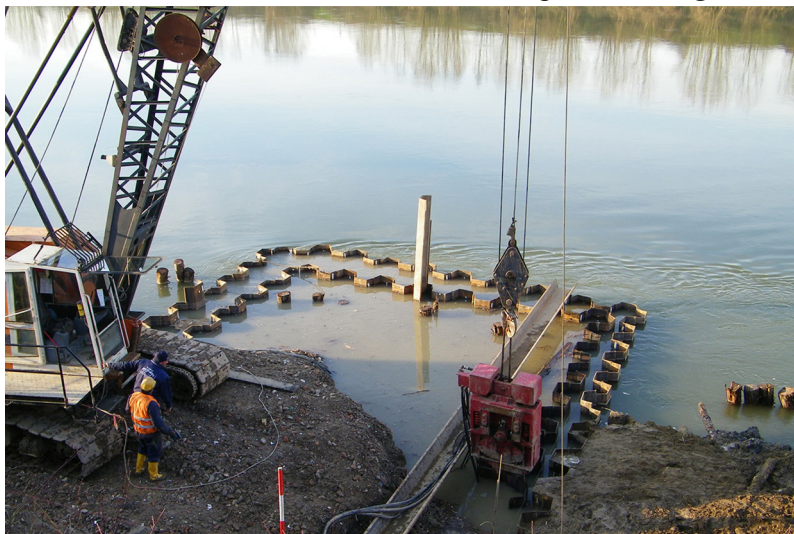
Area cantiere sommersa dalle acque dell'Adige
